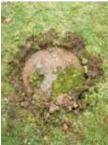
Tampon d'ouvrage enterré non visité, donc non entretenu
